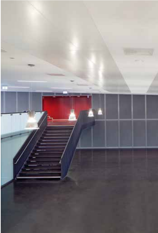
③ В фойе установлены стильные потолочные системы отопления и охлаждения с подвесными светильниками.
