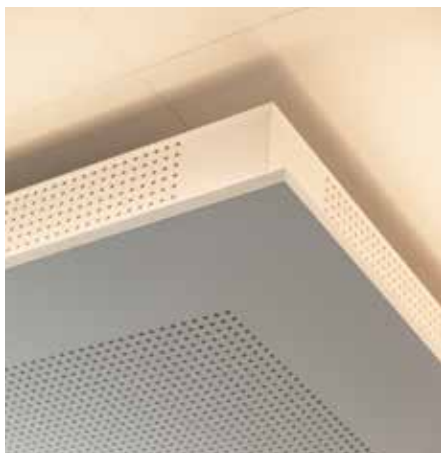
Die Geräuschdämmung übernimmt die Kühldecke: Schallwellen gelangen durch die Perforation der Gipskartonplatten direkt in ein Schallabsorptionsvlies, von dem sie absorbiert werden.
