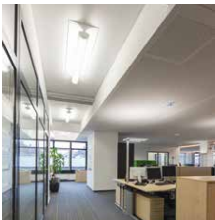
Die Ausführung der Zehnder Kühldecke als Gipskartonsegel ermöglichte eine flexible und damit optimale Anpassung des Deckenspiegels an die teilweise sehr unregelmäßig vorhandene Anordnung von Stützen, Unterzügen und Deckenfeldern.
