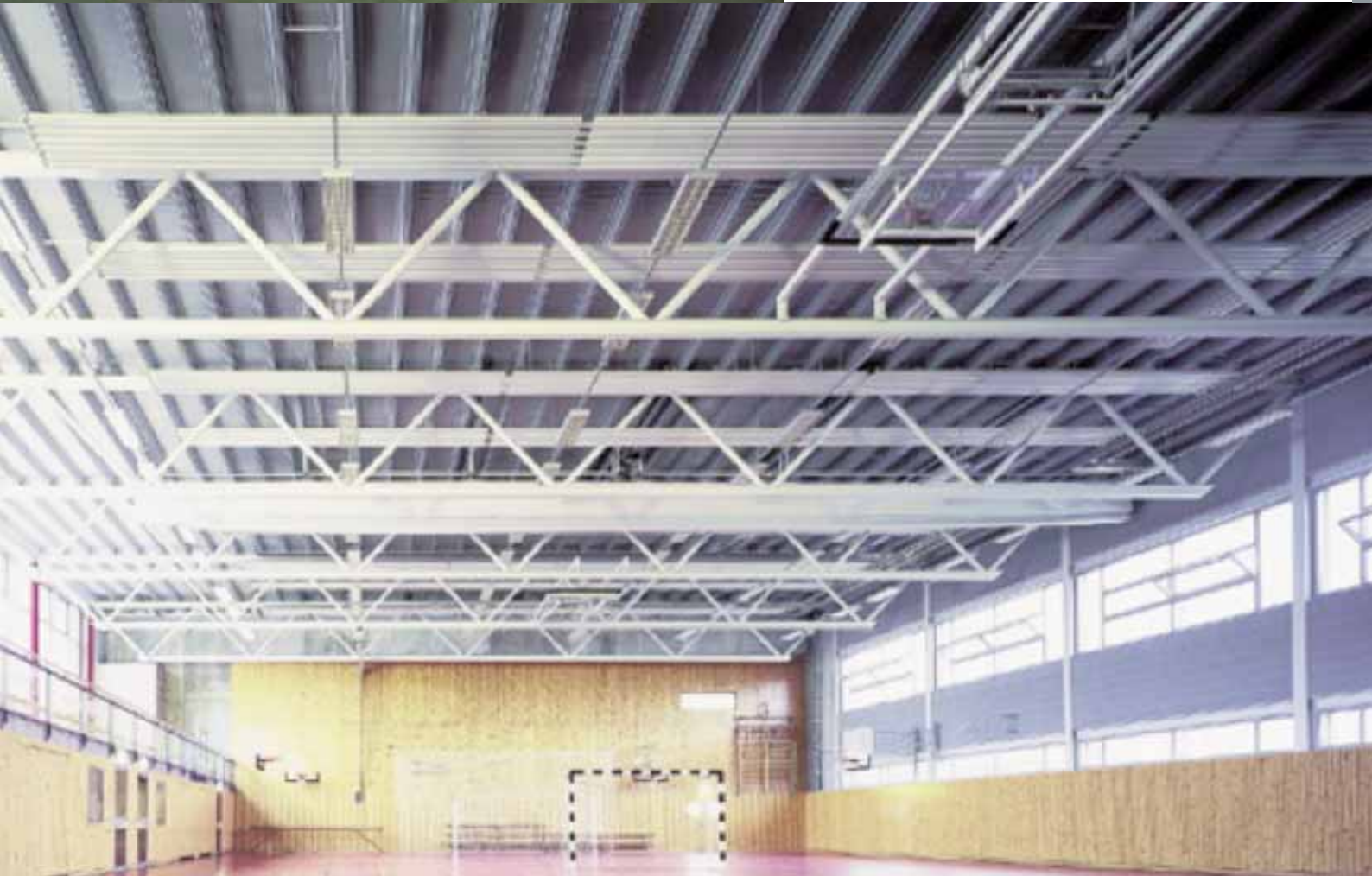
Sporthalle des Oberstufenzentrums Hennigsdorf. Zehnder Deckenstrahlplatten mit Ballabweisgittern.
