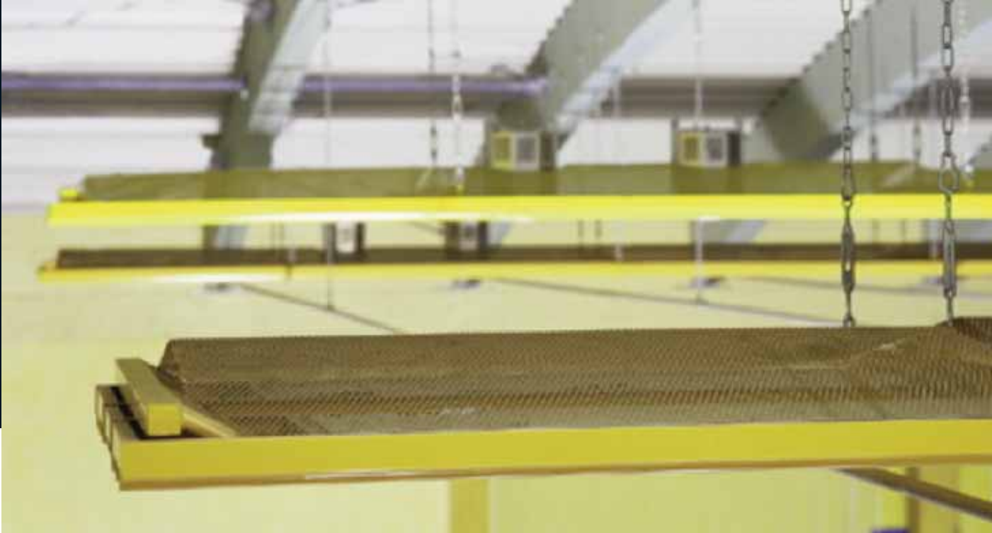
Geschwister-Scholl-Halle der Waldorfschule Offenburg. Zehnder Deckenstrahlplatten mit Ballabweisgittern, Lampenaussparungen und hochgezogenen Kopfstücken.
