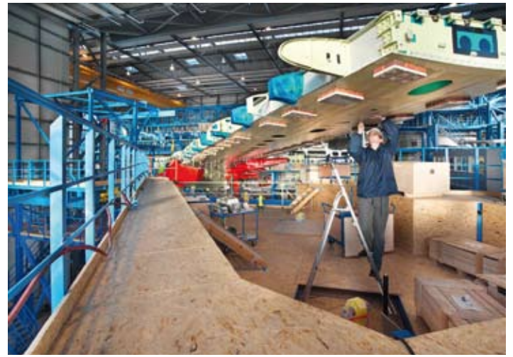
In der Versuchshalle waren wegen der äußerst sensiblen Messprozesse am Airbus 380 ungewöhnlich hohe Temperaturen von 20°C gefordert. Deshalb wurden zur Beheizung ausschließlich Deckenstrahlplatten eingesetzt, deren Energieeffekte bei diesen Temperaturanforderungen voll zum Tragen kommen.
